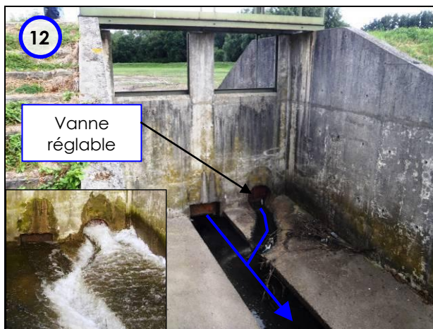
Sortie du bassin de rétention régulé par vanne réglable.
