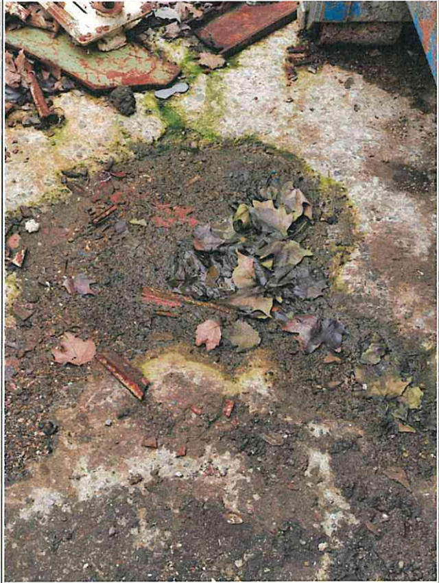
Photo 24 dalle abîmée au 185 avenue du Général Castermant - Chelles
